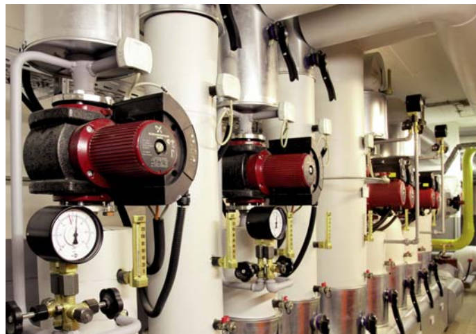
Zu den gering-investiven Energiesparmaßnahmen gehört auch eine Überprüfung der Hydraulik und der Pumpenlaufzeiten.
