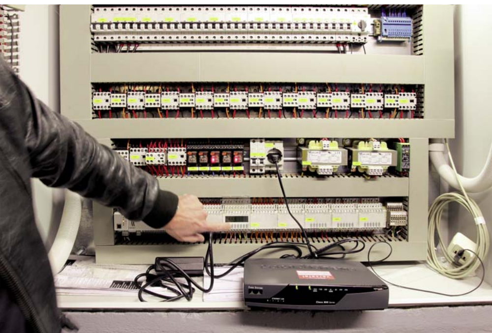
Die Schnittstelle zwischen der VorOrt-Regelung und der Leitzentrale übernimmt ein DSL-Router (Cisco), der vom Telekommunikationsanbieter Versatel zur Verfügung gestellt wird.
