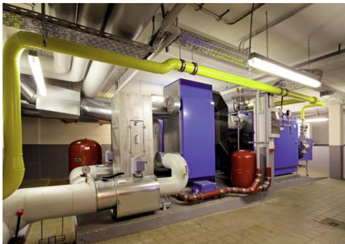
Wo immer möglich und auch wirtschaftlich werden Gas- und Wärmezähler mit Zählimpuls nachgerüstet, um den Nutzungsgrad der Heizkessel zu überwachen.
